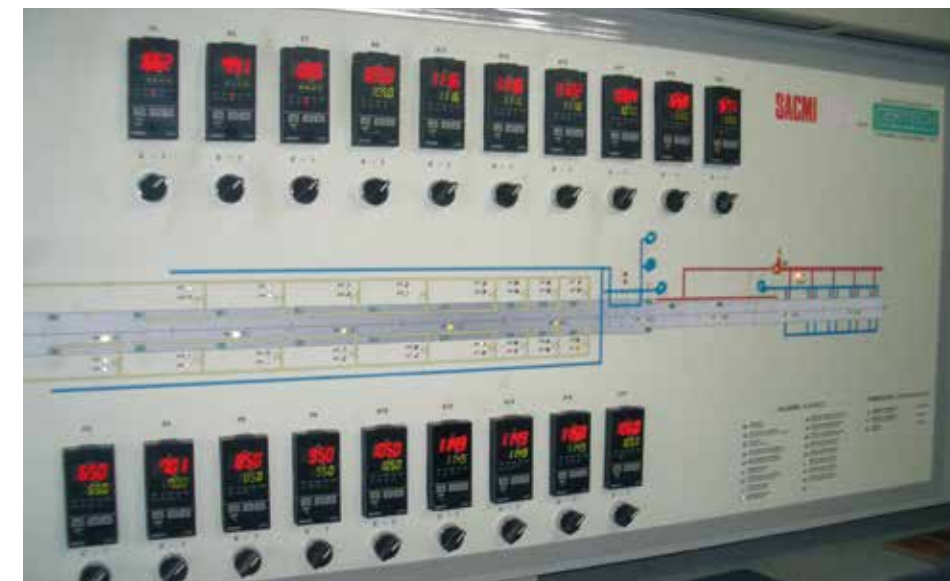
Dettaglio del sinottico del forno sopracitato durante la fase di messa in funzione. Detail of the above mentioned kiln's mimic panel during commissioning. Detalle del sinóptico de dicho horno durante la puesta en marcha. Détail du tableau synoptique du four sur mentionné durant la phase de mise en fonction.
