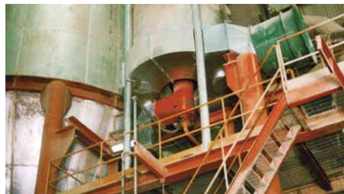
Dettaglio di bruciatore ad aria soffiata e ventilatore di pressurizzazione dopo il potenziamento. Detail of the fanned-circulation burner and pressurization fan after the potentiation. Detalle quemador de aire soplado y ventilador de presurización después del potenciamiento. Détail d'un brûleur à air soufflé et ventilateur de pressurisation après augmentation de puissance.
