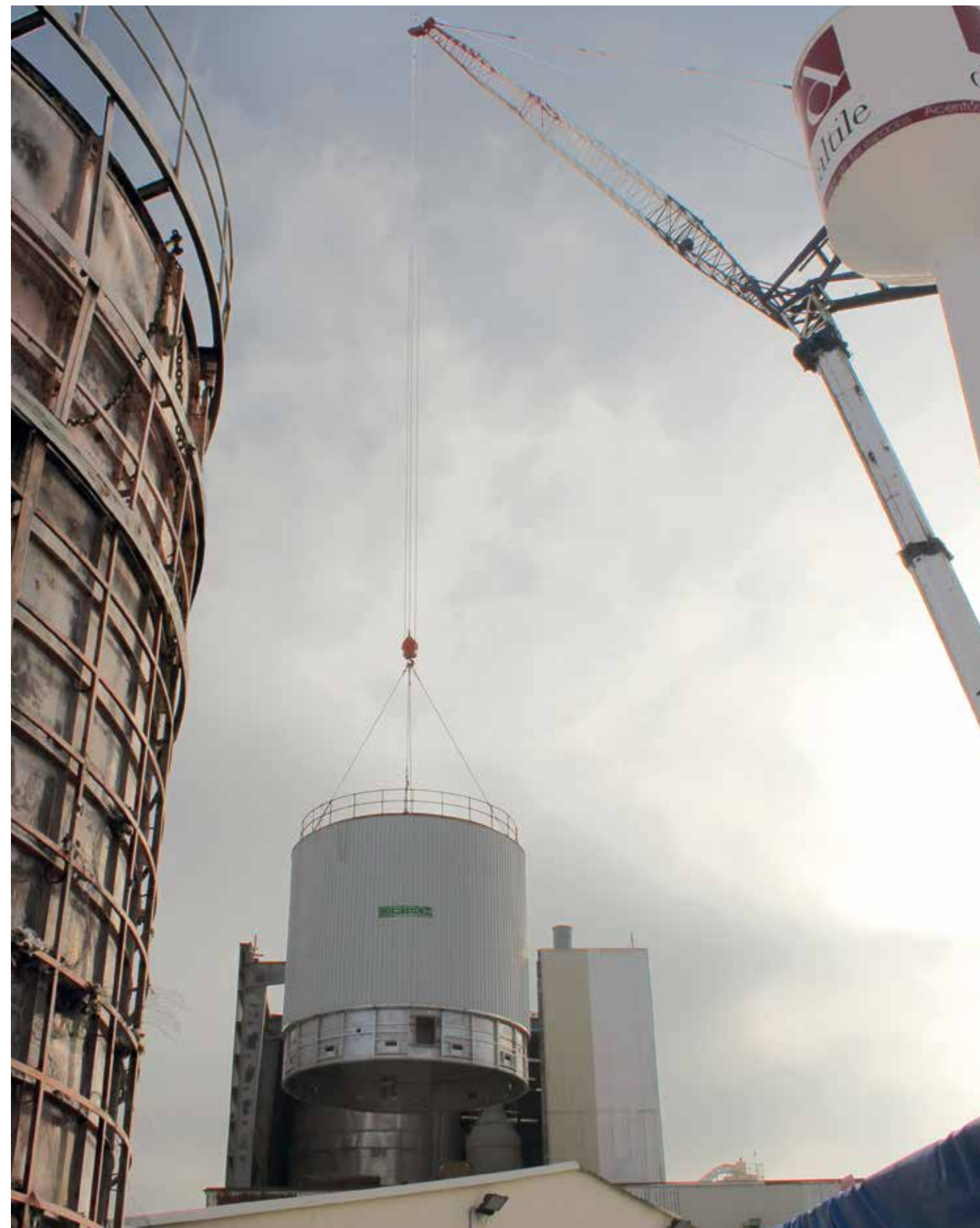
Sostituzione cilindro e cappello con entrata aria calda tangenziale, con uno nuovo di maggiori dimensioni con entrata aria calda centrale. Replacement of cylinder and cap with tangential hot air entry, with a new one with bigger dimensions with central hot air entry. Sustitución cilindro y sombrero con entrada aire caliente tangencial, con uno nuevo de dimensiones mayores con entrada aire caliente central. Remplacement cylindre et chapeau avec entrée air chaud tangentiel, par un nouveau, de dimensions plus grandes avec entrée air chaud centrale.
