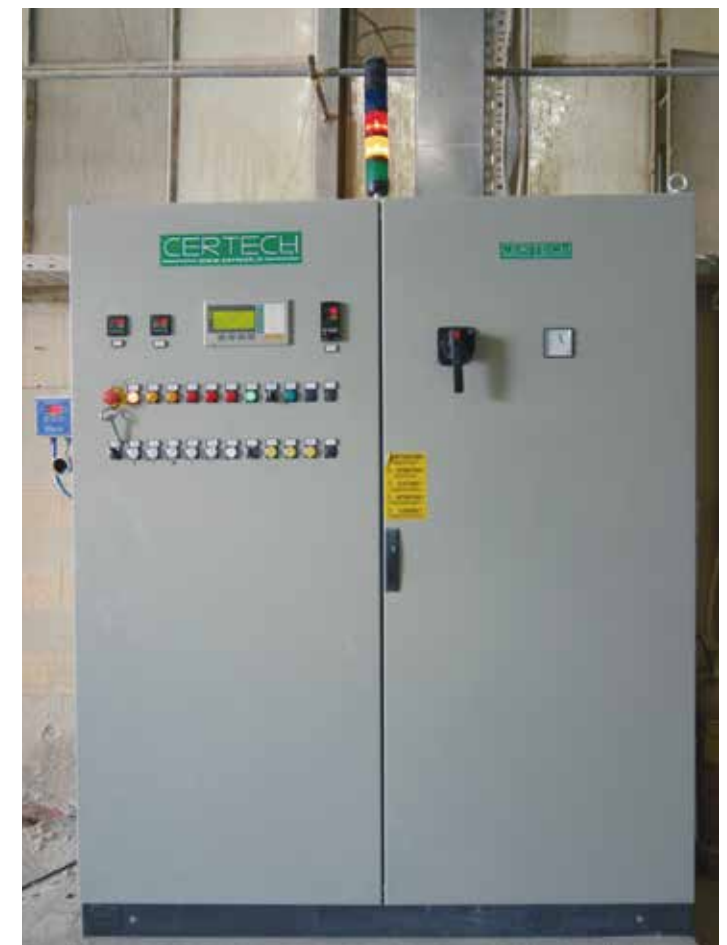
Quadro elettrico base con PLC. Basic electric switchboard with PLC. Tablero eléctrico básico con PLC. Tableau électrique basique avec PLC.
