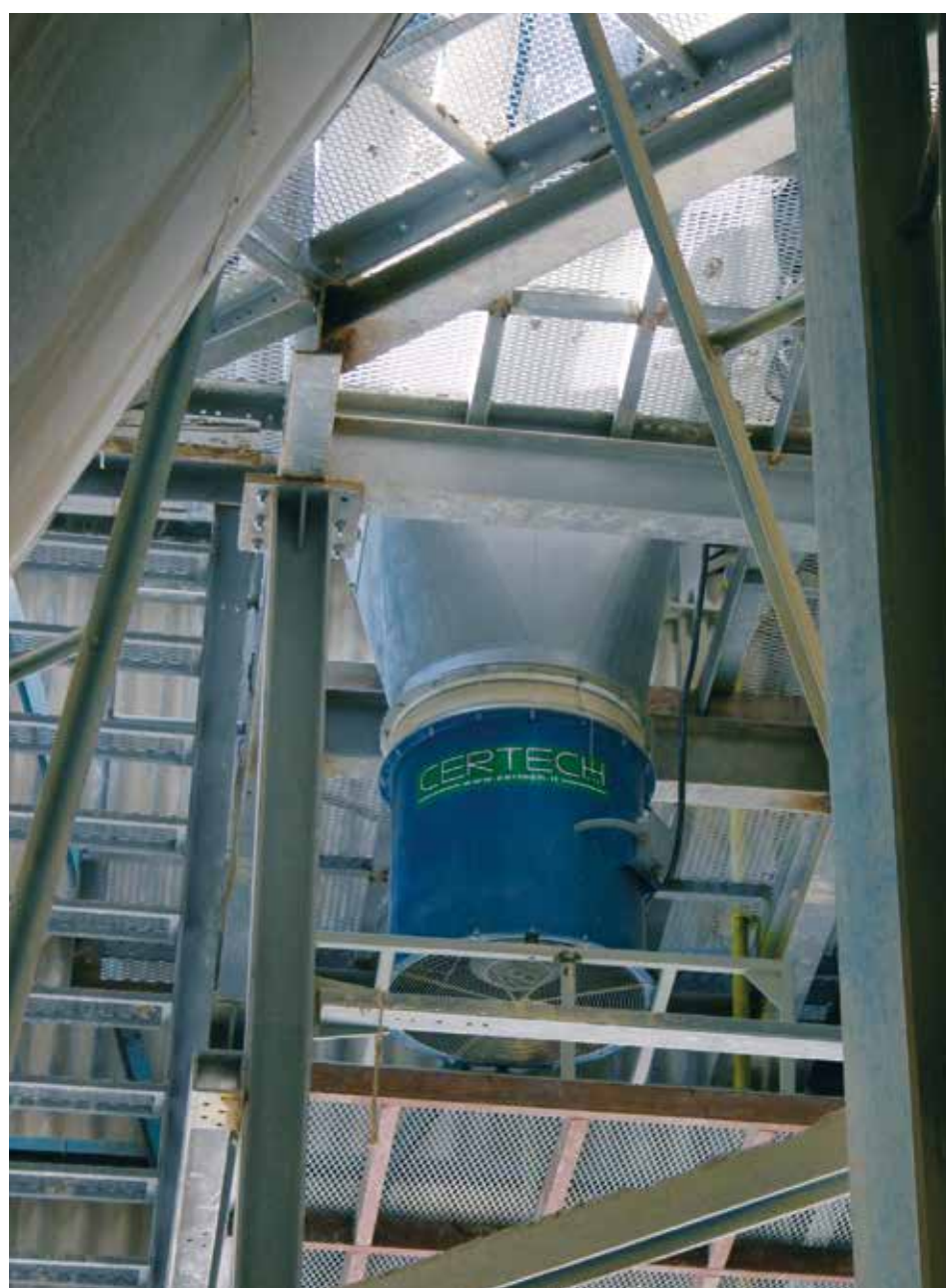
Dettaglio ventilatore di pressurizzazione installato su bruciatore in vena d'aria. Detail of the pressurization fan installed on the duct burner. Detalle ventilador de presurización instalado en quemador en vena de aire. Détail ventilateur de pressurisation installé sur le brûleur en veine d'air.
