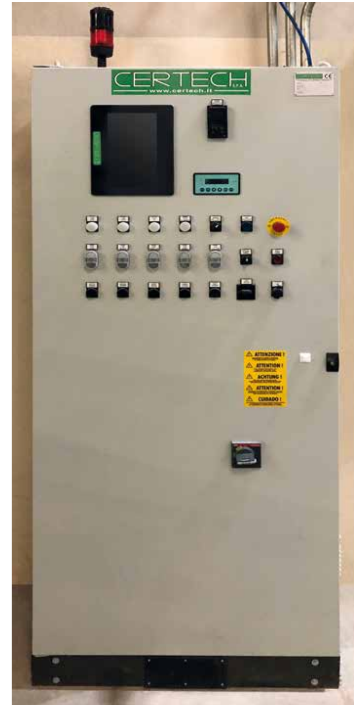
Quadro elettrico con touch screen e PLC. Electric switchboard with touch screen and PLC. Tablero eléctrico con pantalla táctil y PLC. Tableau électrique avec écran tactile et PLC.
