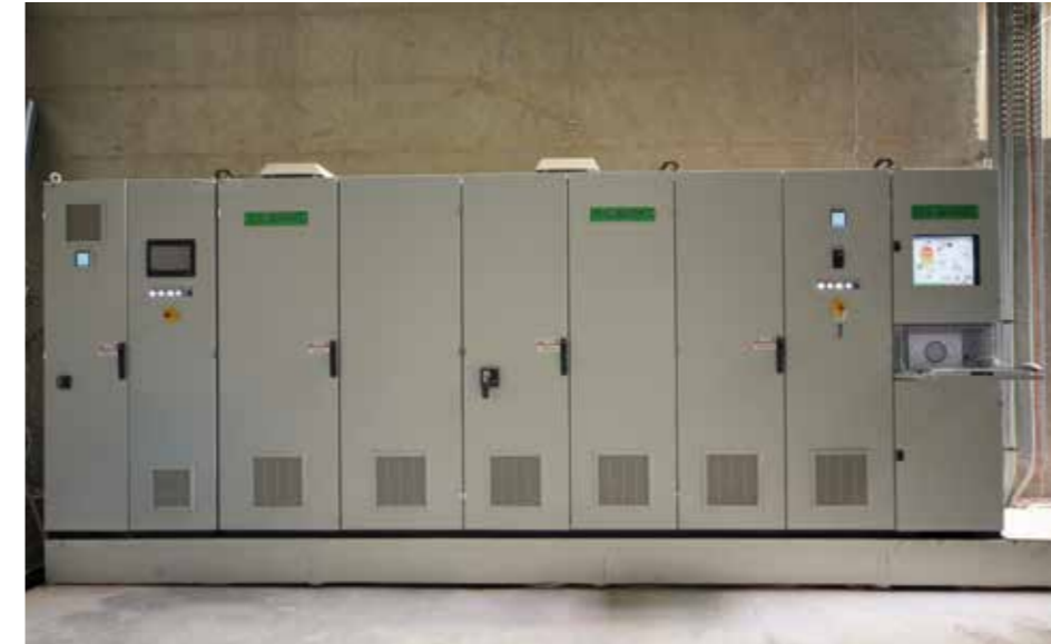
Quadro elettrico atomizzatore CSD 20.000 con inverter su tutti i motori e controllo da remoto. Electric switchboard of CSD 20.000 spray drier with inverter on all motors and remote control. Tablero eléctrico atomizador CSD 20.000 con inverter sobre todos los motores y control de forma remota. Tableau électrique atomiseur CSD 20.000 avec inverter sur tous les moteurs et contrôle à distance.
