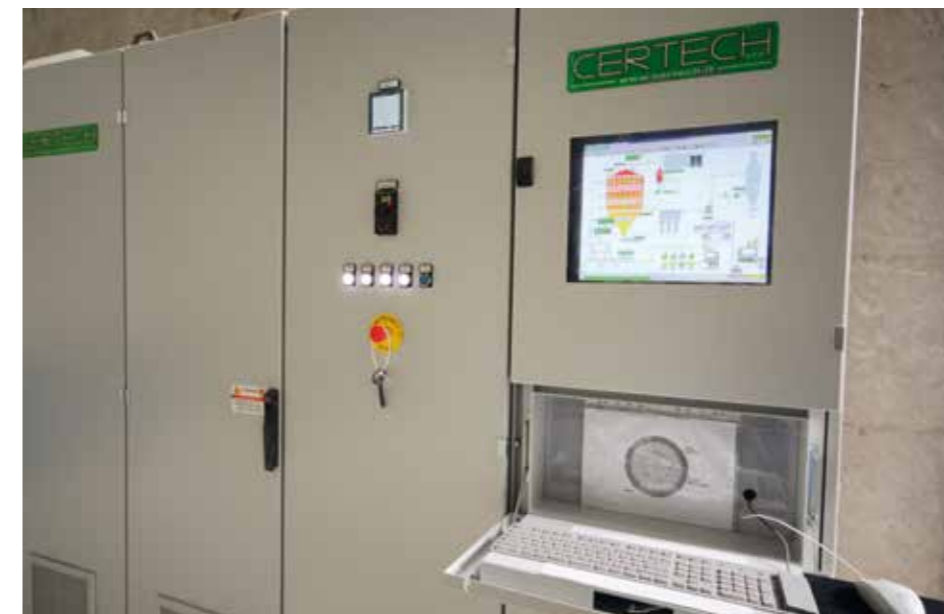
Dettaglio quadro elettrico atomizzatore. Detail of spray drier electric switchboard. Detalle tabelero eléctrico atomizador. Détail tableau électrique atomiseur.
