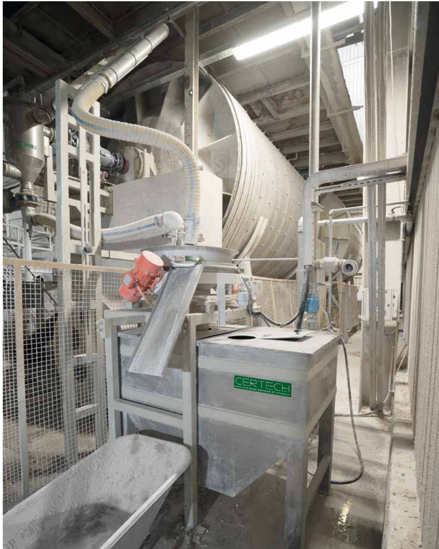
Zona di scarico terzo modulo. Unloading zone of the third module. Zona de descarga del tercer módulo. Zone de déchargement du troisième module.
