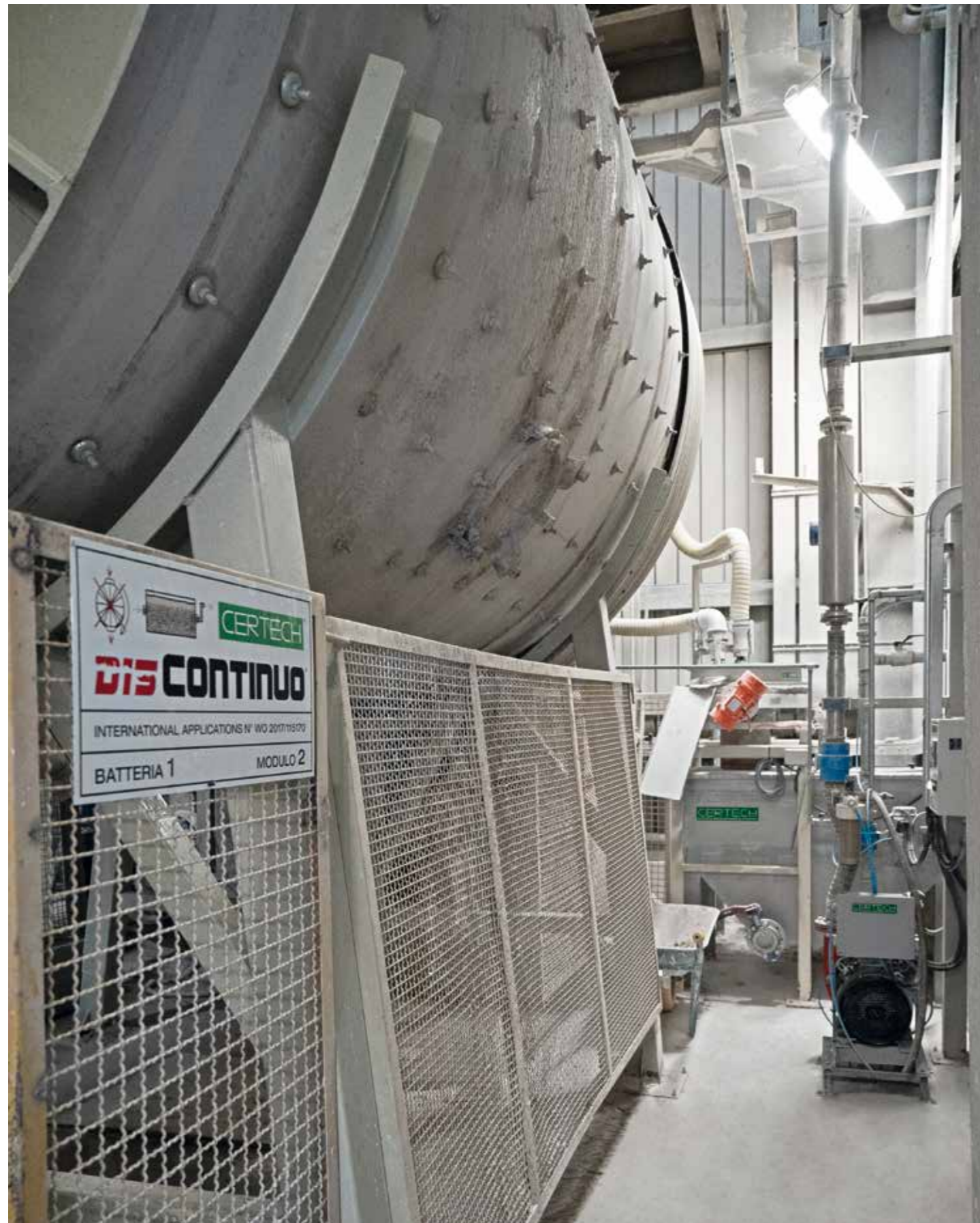
Secondo modulo con setaccio sghiaiatore, vasca e pompa centrifuga di trasferimento barbotina. Second module with sediment excluding sieve, tank and centrifugal pump for slip transfer. Segundo módulo con tamiz desarenador, tanque y bomba centrífuga de transferencia barbotina. Second module avec tamis dégraveur, cuve et pompe centrifuge de transfèremnt barbotine.
