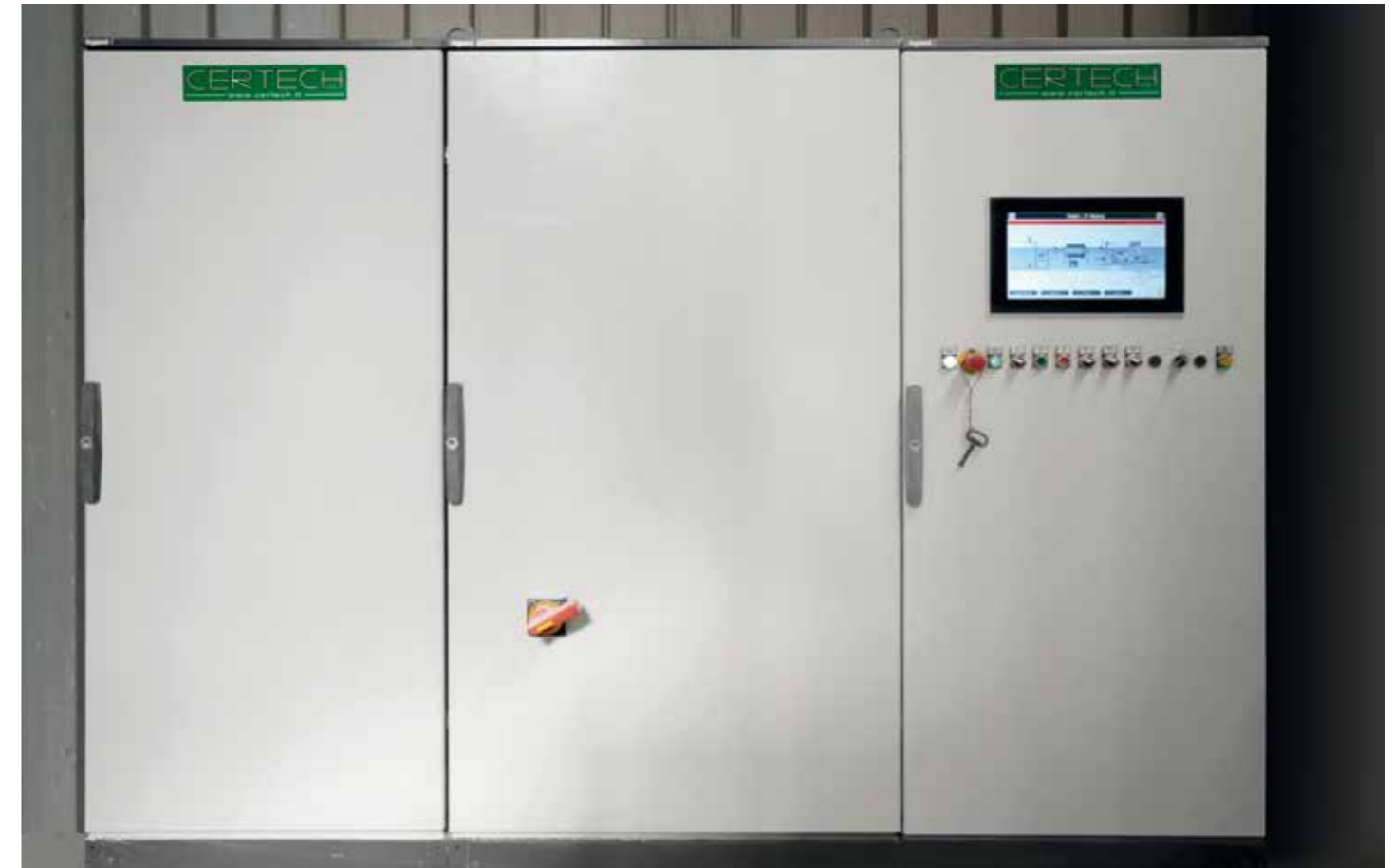
Quadro elettrico di comando mulino continuo modulare a 3 moduli. Electric switchboard for the control of a modular continuous mill with 3 modules. Tablero eléctrico para el control de un molino continuo modular con 3 módulos. Tableau électrique pour le contrôle d'un broyeur continu modulaire avec 3 modules.
