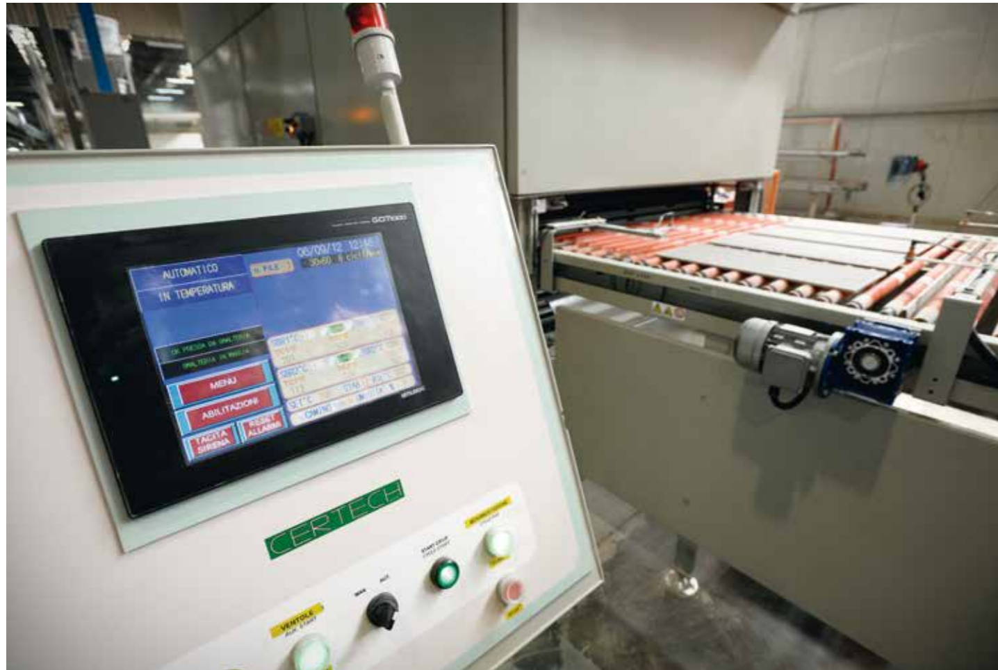
Dettaglio rulliera di carico essiccatoio e quadro di comando essiccatoio con monitor touch screen da 10". Detail of the drier loading roller way and drier control board with 10" touch screen. Detalle cinta de carga secadero y tablero de mando secadero con monitor de pantalla táctil de 10". Détail train de rouleaux de chargement séchoir et tableau de commande séchoir avec moniteur à écran tactile de 10".
