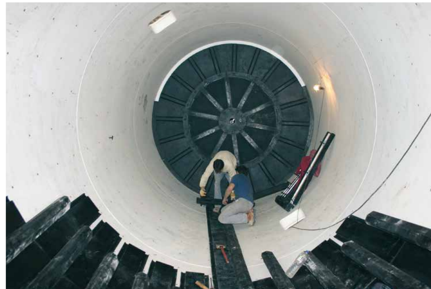
Montaggio del rivestimento in gomma in un mulino con capacità di 160.000 litri. Installation of the rubber lining on a mill with a capacity of 160,000 litres. Montaje del revestimiento de goma de un molino con capacidad de 160.000 litros. Montage du revêtement en gomme dans un moulin doté d'une capacité de 160 000 litres.
